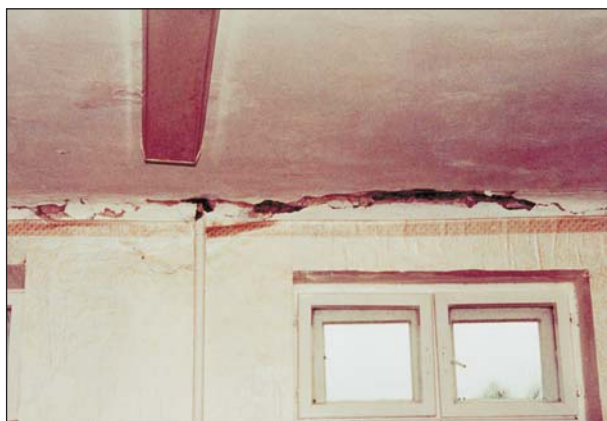
Трещина на стыке потолка и несущей стены в школе пос.Люблино ( I = 6 баллов).
