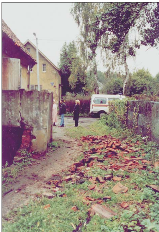
Остатки черепицы и трубы, сброшенные с крыши старого дома на западной окраине Калининграда ( I = 6 баллов).
