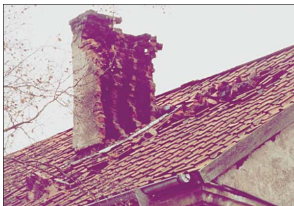
Разрушенная кирпичная труба.
